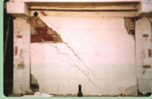
İlk sademelerin ardından çatlayıp molozlaşan tuğla duvar ile çerçevenin taşıyıcılığı azalmıştır
